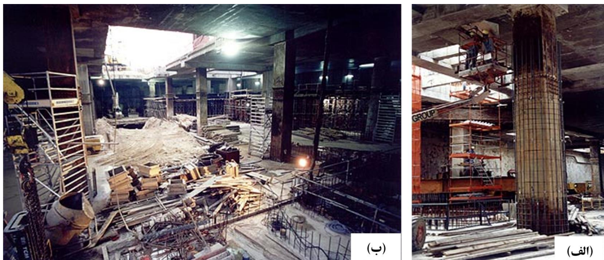
شکل ۷-۱ (الف) اجرای فرآیند بالا-پایین در طبقات زیرزمین. شمع‌های فولادی که پیش از اجرای خاکبرداری نصب شده‌اند در این تصویر دیده می‌شوند که دال سقف‌ها را نگاه می‌دارند. (ب) شمع فولادی که توسط بتن مسلح در برگرفته می‌شود و به عنوان ستون دائم طبقه زیرزمین کامل می‌گردد.
