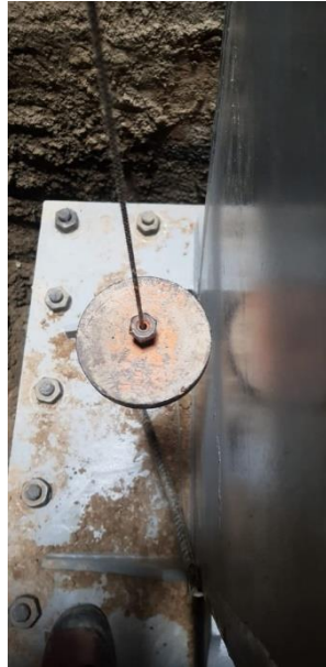
شکل ۳-۲۶ انتقال نقاط محور ستون پیاده شده در سر چاه به پایین چاه و سر شمع جهت نصب و شاقولی ستون مستقر بر صفحه ستون
