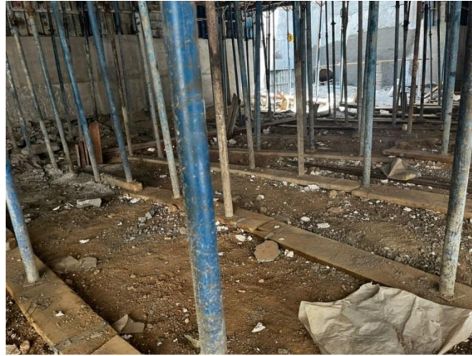
شکل ۳-۱۱۰ استفاده از الوارهای چوبی در زیر جک های سقف به منظور توزیع مناسب بار سقف تازه ریخته شده و مابقی ملحقات قالب بندی به سطح زمین و جلوگیری از فرورفتن جک ها در خاک و نشست آنها هنگام اجرای سقف
