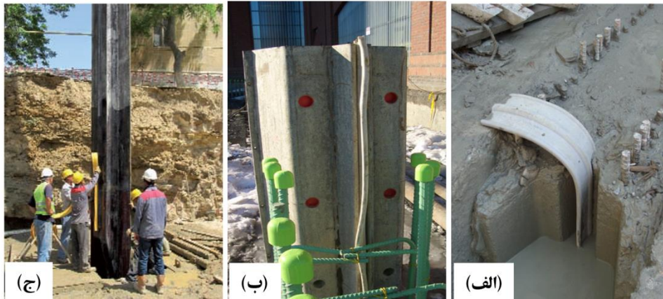
شکل ۳-۵۸ الف) نصب صفحات انتهایی در ترانشه، ب) نصب نوار آب‌بند داخل شیار صفحات انتهایی، ج) قرار گرفتن نوار آب‌بند داخل قطعه‌ای از دیوار که بتن‌ریزی شده است و با بتن‌ریزی قطعه مجاور نوار آب‌بند درز بین دو قطعه را پر خواهد کرد
