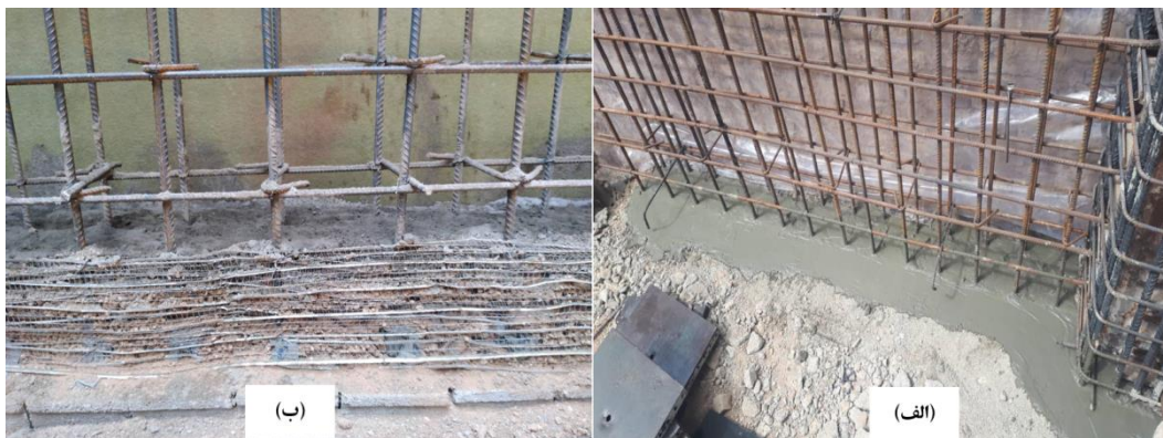
شکل ۳-۹۷ محافظت از طول مورد نیاز انتظار در پایین دیوار حائل برای وصله میلگردهای طولی به میلگردهای طولی دیوار طبقه پایین، (الف) حفر کانال پای دیوار و جایگذاری میلگردهای اصلی و پر کردن کانال با خاک و استفاده از پوشش ماسه و سپس یک لایه نازک دوغاب سیمان، (ب) محافظت از طول میلگرد پایین‌تر از تراز پایین دیوار حائل به وسیله رایبیتس و پر کردن طول وصله با خاک، یک لایه ماسه و دوغاب نازک سیمان
