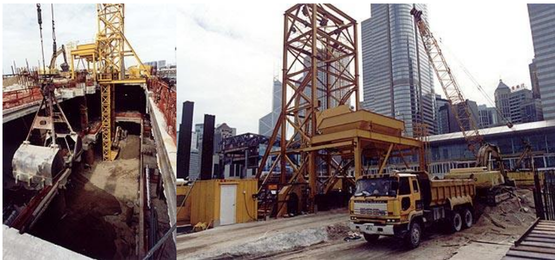
شکل ۴-۱ انجام حفاری طبقه زیرزمین. خاک در زیر تراز دال طبقه همکف حفاری می‌شود. کامیون‌ها برای حمل خاک در بالا و تراز زمین کنار بالابر خاک قرار می‌گیرند.
